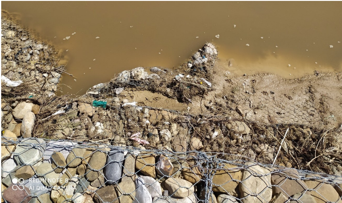
Figura 2.18 – Colapso de colchonetas.
