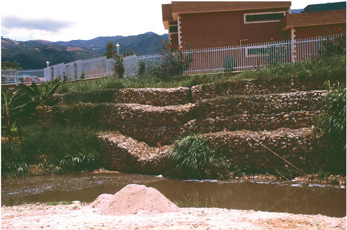
Figura 2.12 – Efecto de socavación en un muro de gavión.
