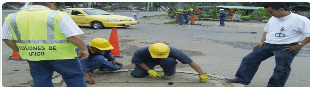
Figura 2.20 Diagnóstico de elementos de seguridad vial.
