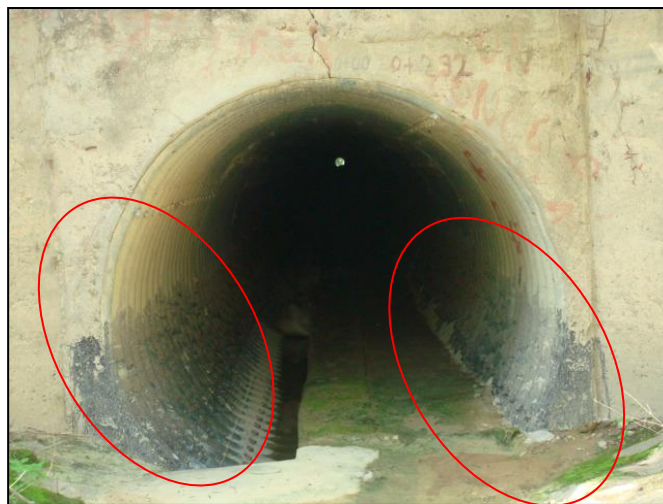
Estado actual de la alcantarilla N° 1 (con oxidación y sedimentos)
