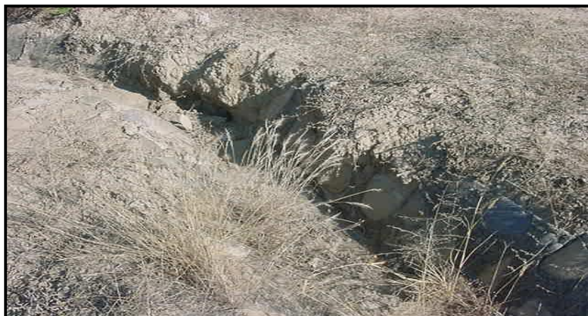
Figura 2.13 Erosión en surcos
