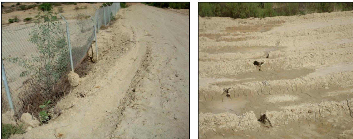
Figura 3.20: socavación al lado del camino perimetral lado sur (final pista)
