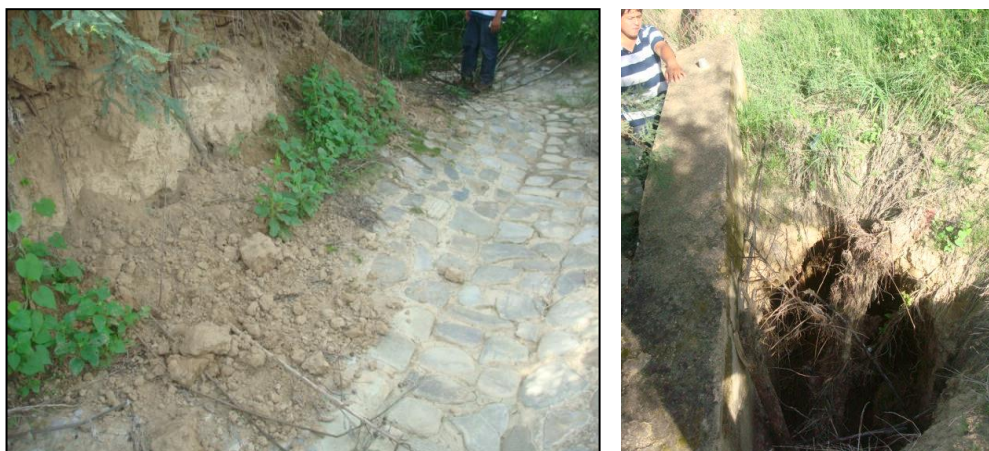
Figura 3.8: Desmoronamientos y socavaciones en la zona próxima.
