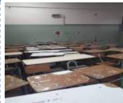
Figura 2 Aulas en mal estado Fuente: https://www.ies21.edu.ar/noticias/122-tips-periodico-el-pais-Tarija
