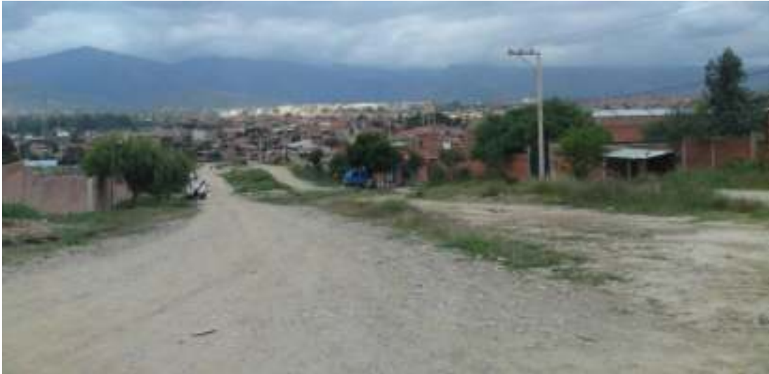
Vías en mal estado que en época de lluvia se pone intransitable
