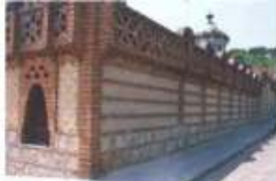
Fig 27 Caballerizas Guell de A. Guadi, ejecutadas en Tapial calicastroado sobre con albetularia y pilotes en calicastroado
