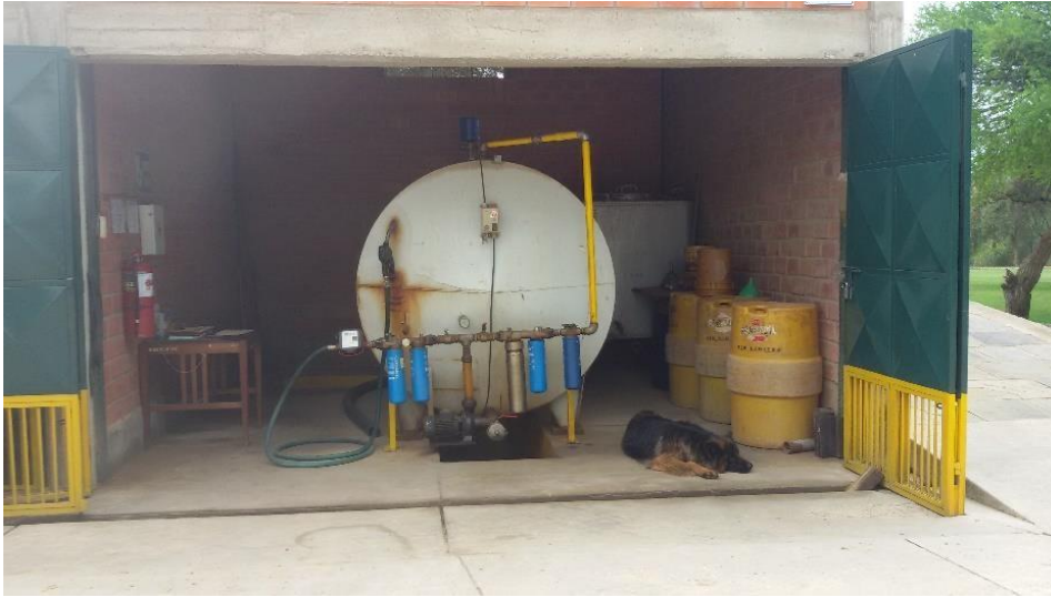
Ilustración 13 Almacén de Combustible
