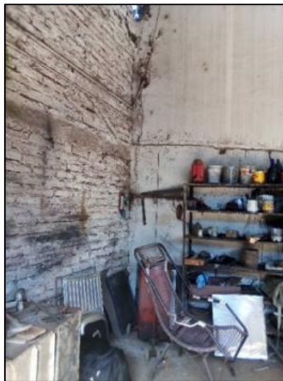
Figura 3-3. Falta de limpieza en área de trabajo
