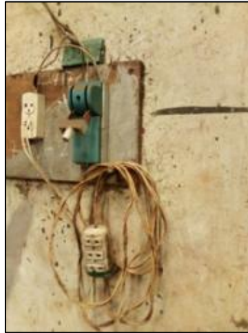
Figura 3-4. Falta de limpieza en conexiones eléctricas
