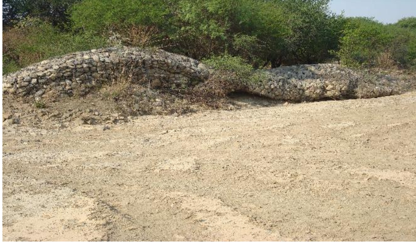
Figura 1.16: Gavión colapsado. Fuente: Elaboración propia.
