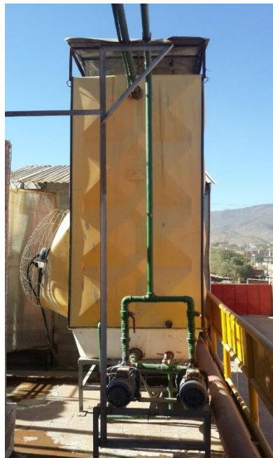
Figura 2-9: Torre de Enfriamiento de Agua DZ M1-1.
