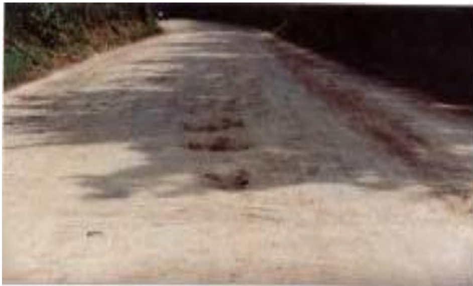
Corrugaciones tramo Bermejo-Los Ingenios
