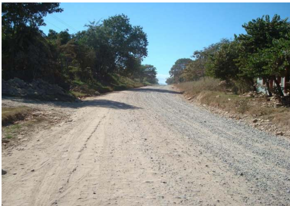
Tramo ripiado en regular estado
