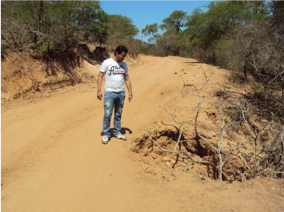
El camino de ingreso a la comunidad de Guirapayete en mal estado.
