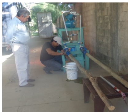
Instalación y puesta en Marcha
