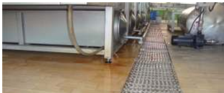
Figura 2-13 Aguas del Proceso de Pasteurización
