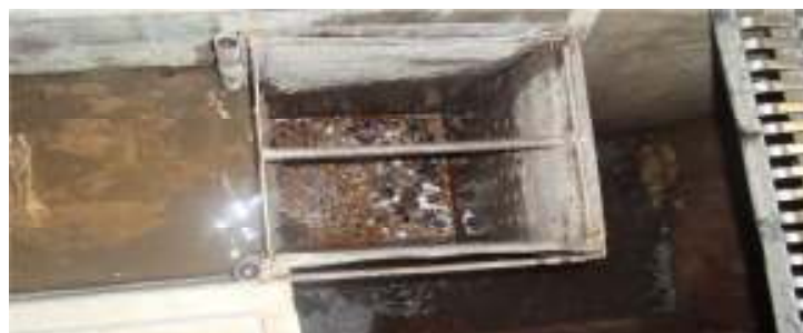
Figura 2-12 Cedazo de Retención de los Sólidos de la Lavadora de Botellas
