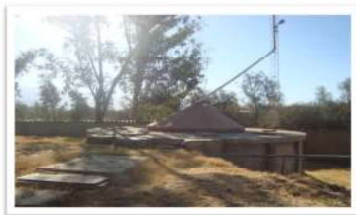
Figura 2-24 Sistema Anaerobio BIORAB-100
