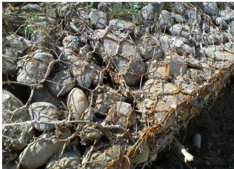
SECTOR “A” EL ALTILLO-CALAMUCHITA. GAVIONES DEFORMADOS, NIVEL SUPERIOR VISIBLEMENTE CORROÍDO. NIVEL INFERIOR NO VISIBLE, COLCHÓN RENO INEXISTENTE. FIGURA 4.12
