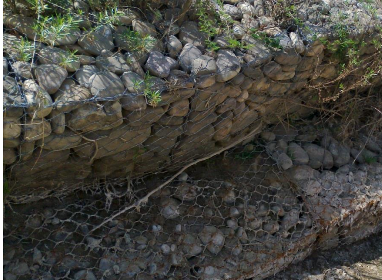
SECTOR “A” EL ALTILLO-CALAMUCHITA. GAVIONES DEFORMADOS, NIVEL INFERIOR VISIBLEMENTE CORROÍDO. COLCHÓN RENO INEXISTENTE. FIGURA 4.11
