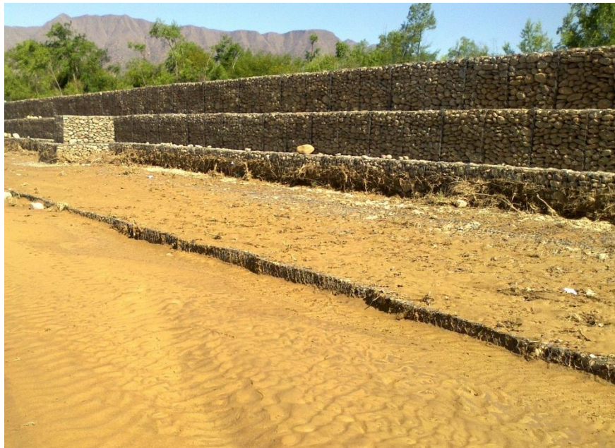
CALAMUCHITA PRIMERA LLEGADA DEL RÍO CAMACHO Y RÍO GUADALQUIVIR 01/11/2013, SE APRECIA LA RETENCIÓN DEL MATERIAL FINO EN EL INTERIOR DEL COLCHÓN RENO, DEBIDO A LA PRESENCIA DE GEOTEXTIL EN SU INTERIOR. FIGURA 4.13
