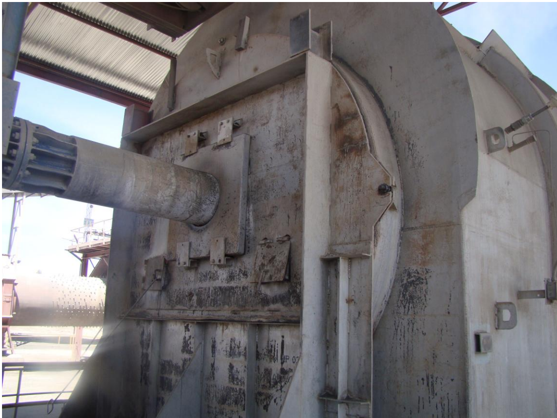
Fotografía II. 8 QUEMADOR DE GAS DEL HORNO FLS
