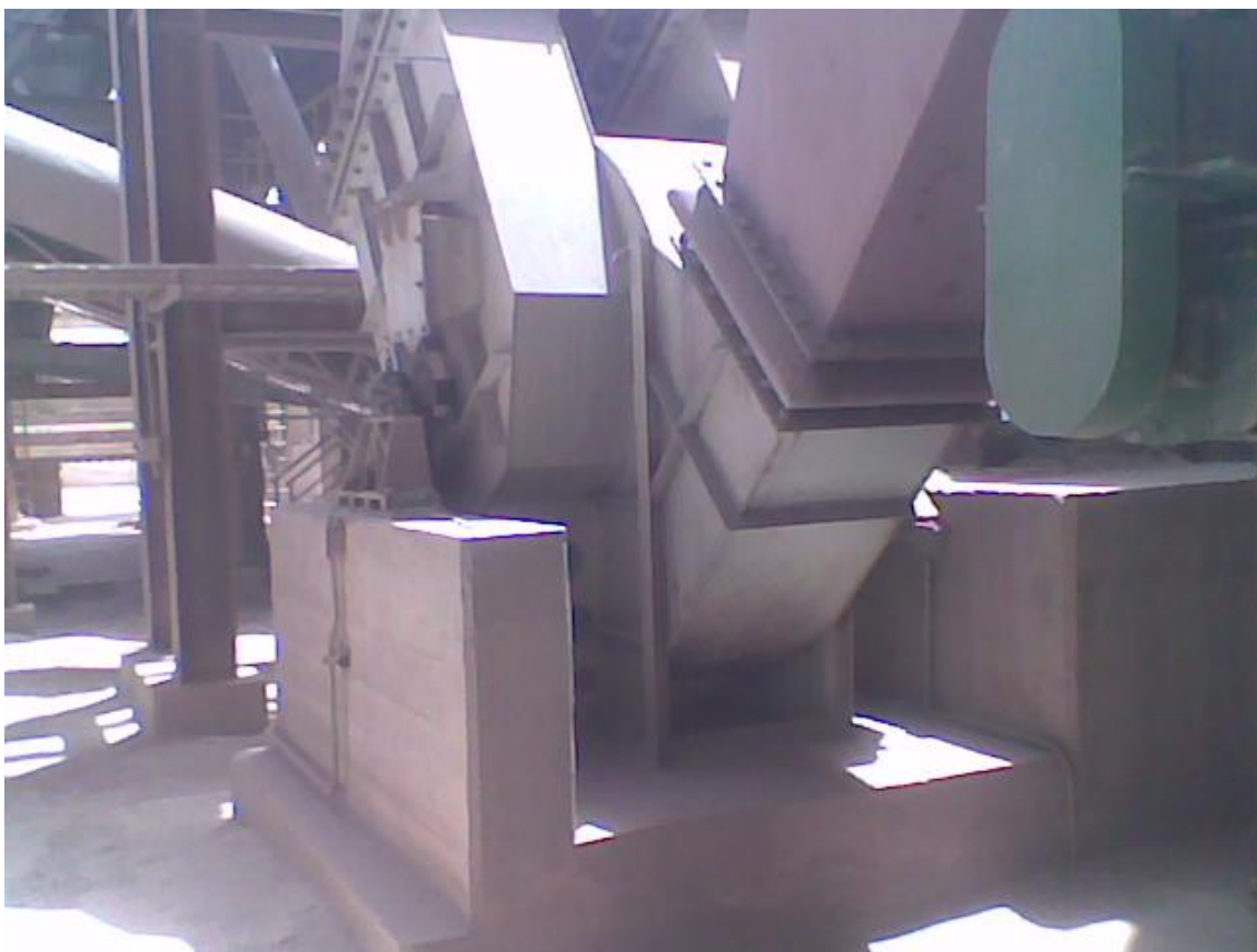
Fotografía II.1 VENTILADOR DE TIRO INDUCIDO 400VE14 DE GASES CALIENTES
