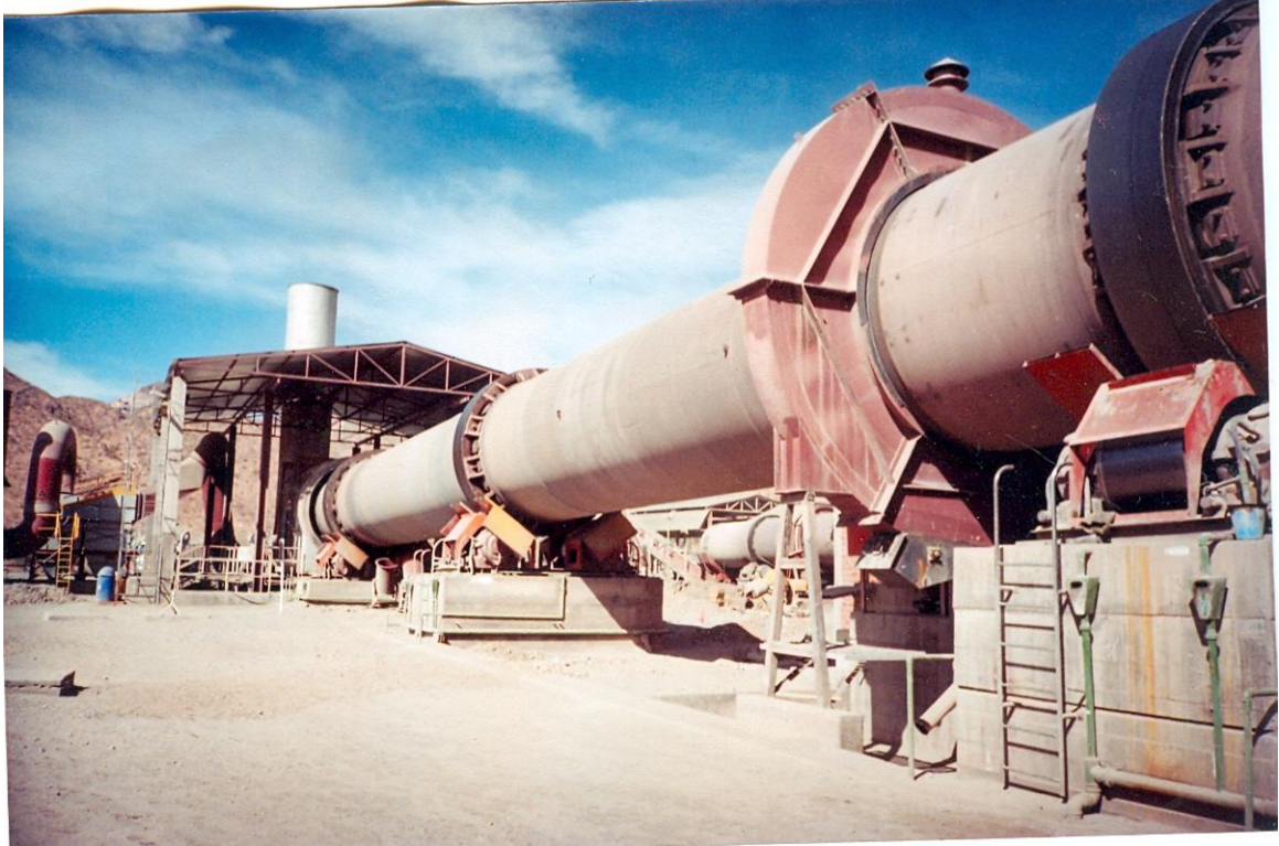
Fotografía II.7 HORNO DE CLINKERIZACIÓN FLS 400HR
