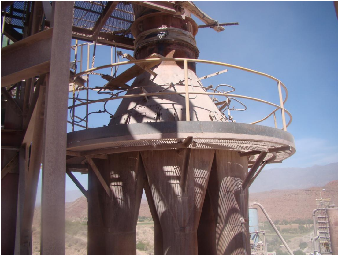
Fotografía I. 2 CAMPANA SUPERIOR DE ENTRADA DE LOS GASES CALIENTES A LA TORRE DE REFRIGERACIÓN
