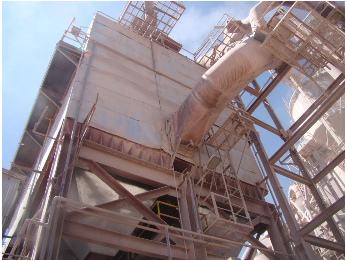
Fotografía II.2 FILTRO DE MANGAS 400FM01
