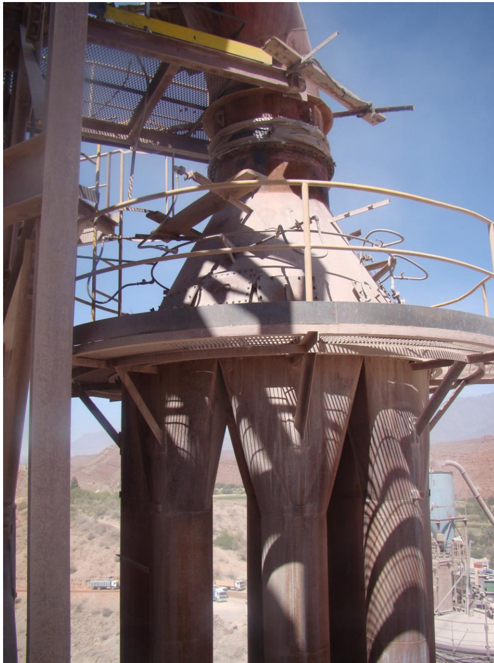
Fotografía II.3 ENTRADA AL ACONDICIONADOR REFRIGERADOR DE GASES CALIENTES
