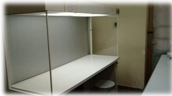
Cámara de flujo laminar
