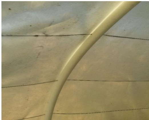
Tubos pbs con alambre galvanizado y agrofil
