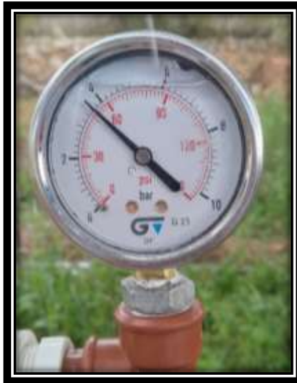
Figura 3.6 Manómetro Fuente: Elaboración propia
