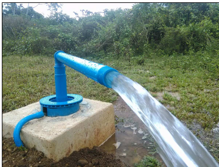
Figura 12. Pozo de extracción de agua subterránea
