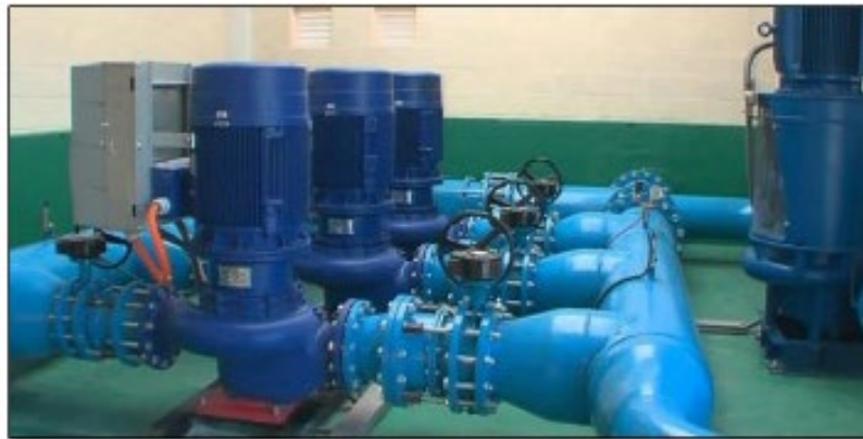
Figura 11. Estación de bombeo
