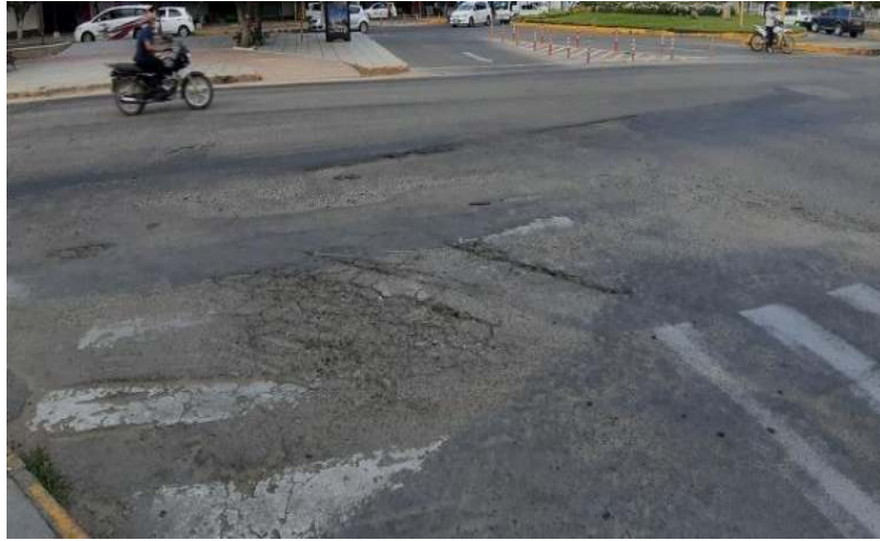
Figura II.27: Mal estado de la superficie de rodadura sobre la avenida Víctor Paz Estensoro y calle España-Acceso 1
