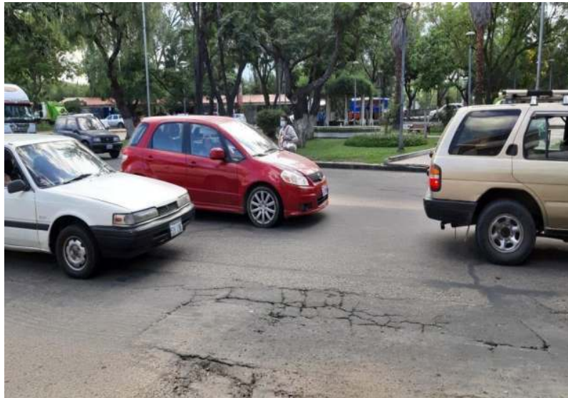
Figura II.28: Mal estado de la superficie de rodadura sobre la avenida Panamericana y calle 15 de abril
