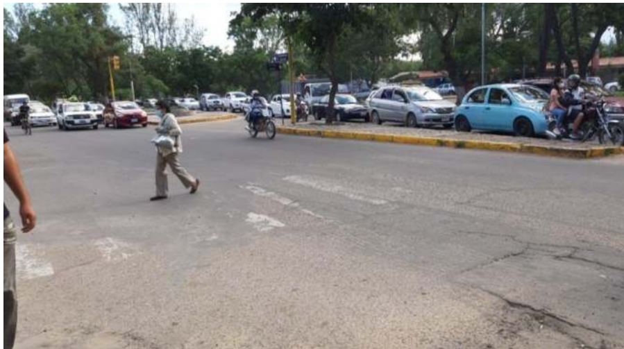
Figura II.40: Cruce peatonal en mal estado en la avenida Panamericana y calle 15 de abril
