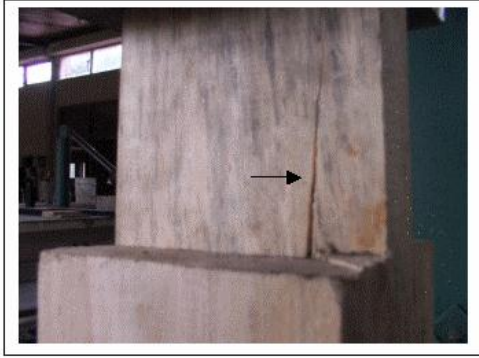
Fotografía N° 24. Desgarramiento de Muestra N° 1.
