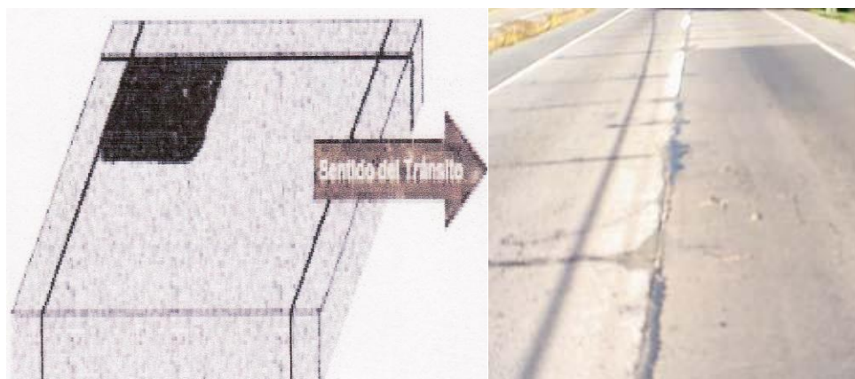
Fig. 2.19 Parchados y reparaciones
