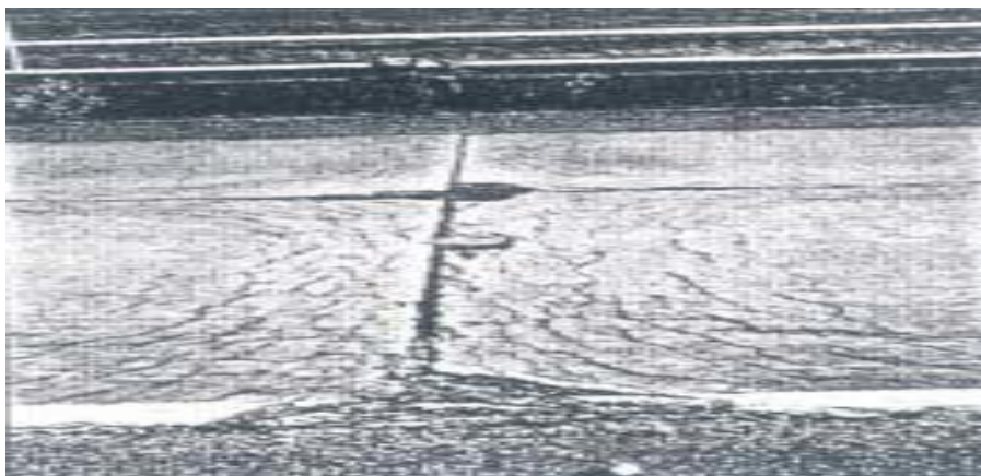
Fig. 2.18 Fisuras por mal funcionamiento de juntas
