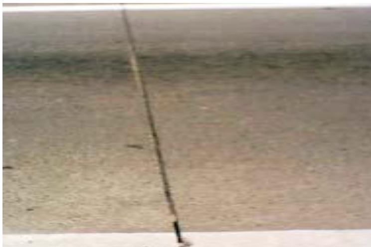
Fig. 2.16 Deficiencia en el material de sello
