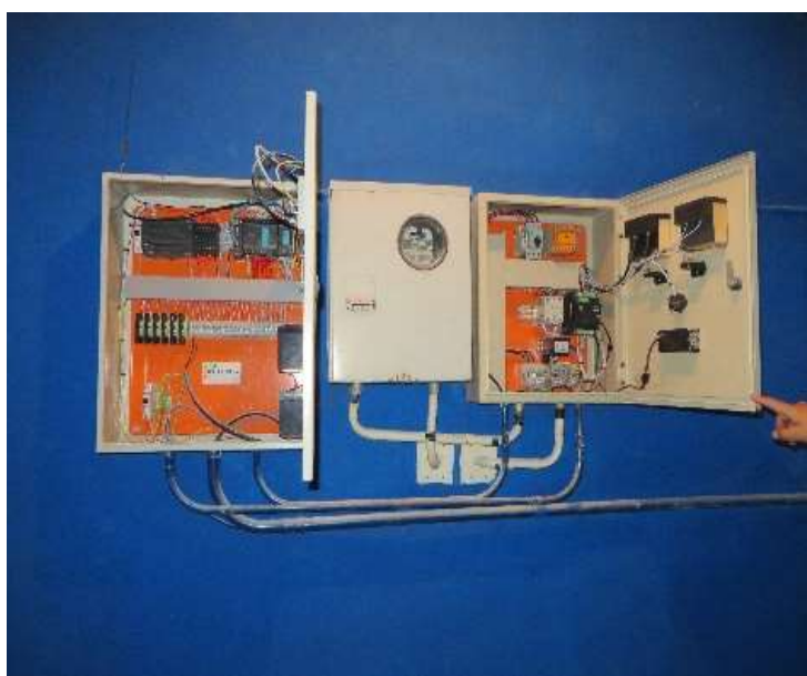
Figura 45: Dosificador del Pozo YC-34
