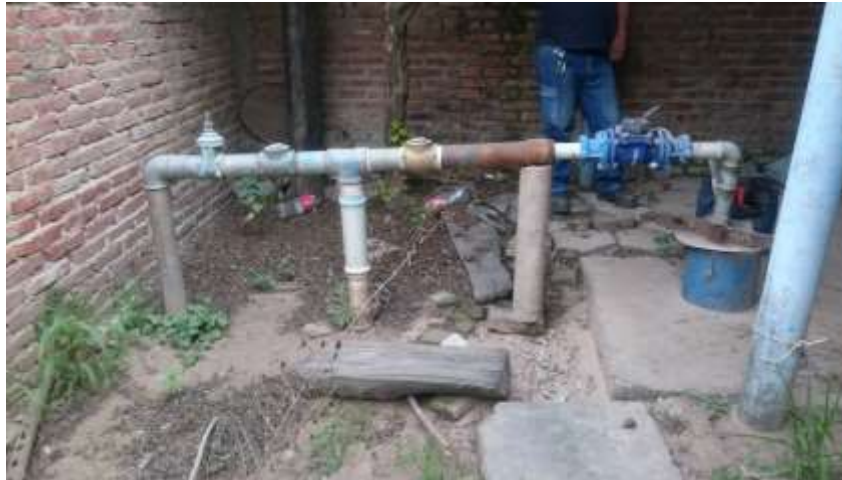
Figura 19: Registro fotográfico del Pozo N°5
