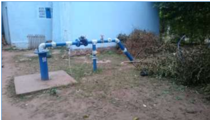
Figura 17: Registro fotográfico del Pozo N°4
