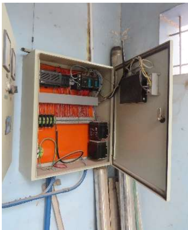
Figura 49: Dosificador del Pozo el Cárcamo
