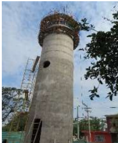
Figura 29: Registro fotográfico del tanque del Pozo N°9
