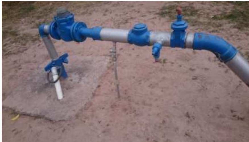
Figura 21: Registro fotográfico del Pozo N°6
