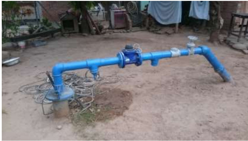
Figura 23: Registro fotográfico del Pozo N°7
