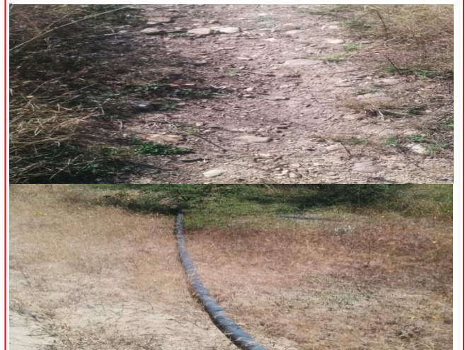
Img.8. Canales y tuberías para riego
