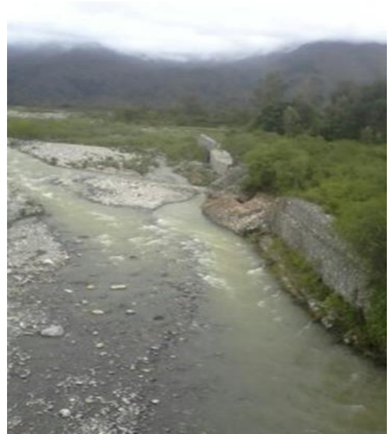
Obras de protección en deterioro
