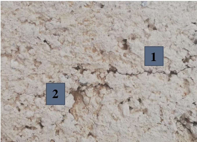
Figura 3.39. Fisuras sección 1: Monitoreo 7 días Fuente: Fotografía propia
