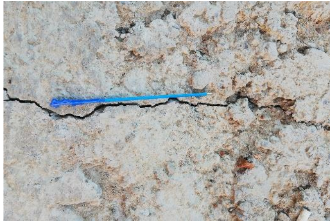
Figura 3.45. Sección 1: fisura de corte 35 días Fuente: Fotografía propia
