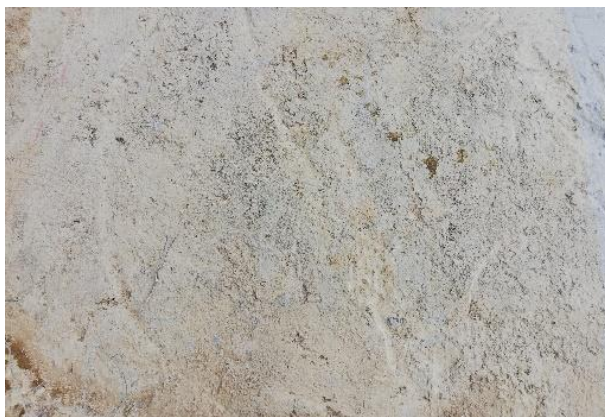
Figura 3.46. Sección 2: sin fisuras 30 días Fuente: Fotografía propia
