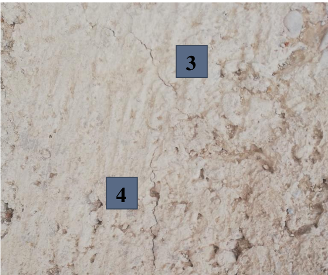
Figura 3.40. Fisuras sección 1: Monitoreo 7 días Fuente: Fotografía propia
