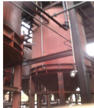
Figura 3.4. Tanque de almacenamiento de vinaza Fuente: Fotografía propia
