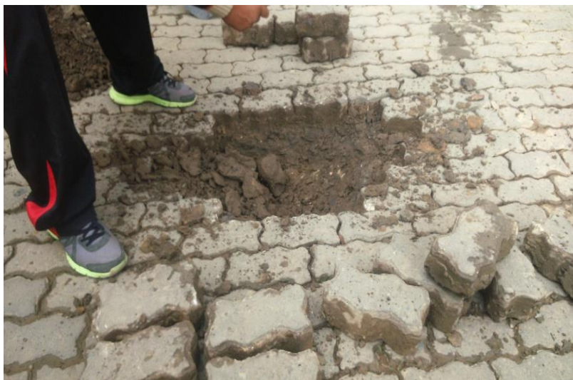
Figura 22. Extracción de la muestra.
