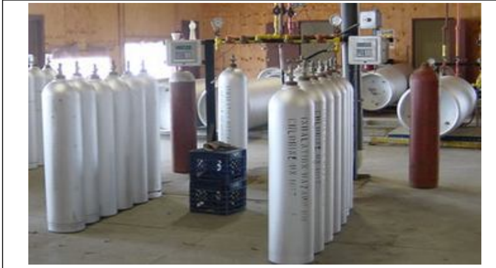
Figura 2.24 Equipo de desinfección (mediante gas cloro).-
