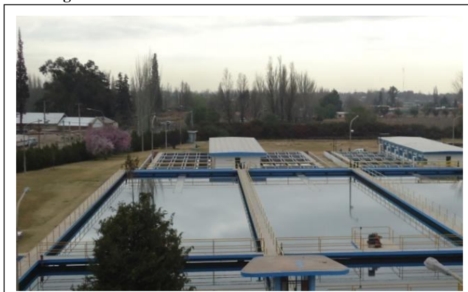
Figura 2.22 Laguna de decantación
