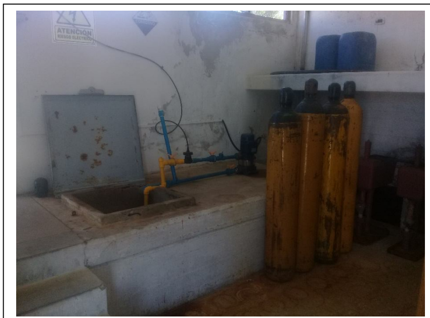
Tubería y bomba del gas cloro
