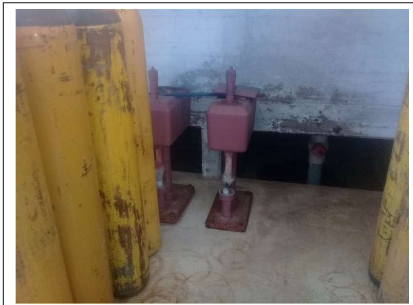
Dosificador de hipoclorito por gravedad
