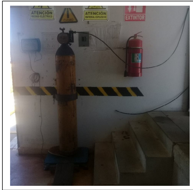
Tanque del gas cloro
