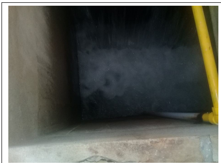
Tubería que entra para el gas cloro
