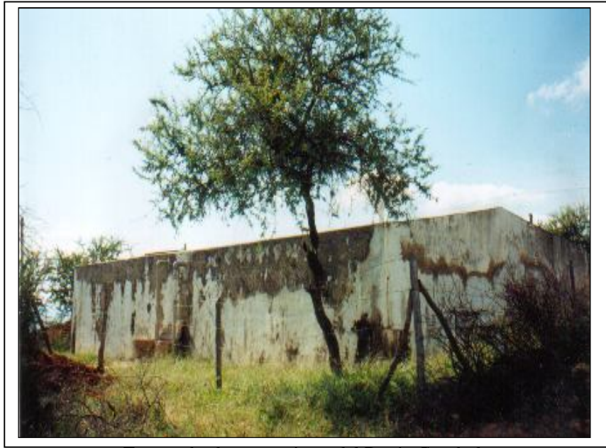
Tanque de almacenamiento del Barrio Catedral
