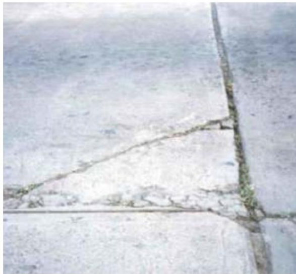
Figura 2.26 Fisura de esquina
