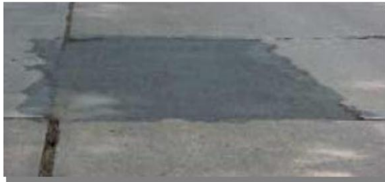
Figura 2.40 Parchado y reparaciones del servicios público
