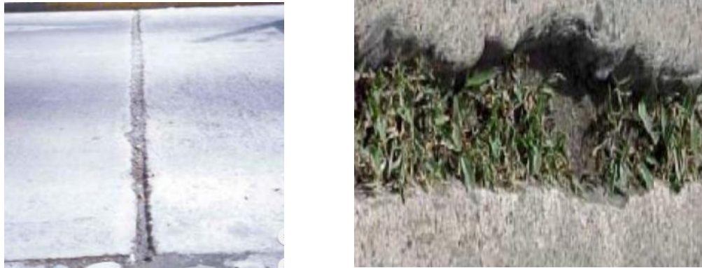
Figura 2.37 Deficiencia de material de sello
