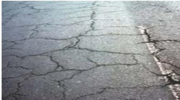
Figura 2.28 Fisuras en bloque
