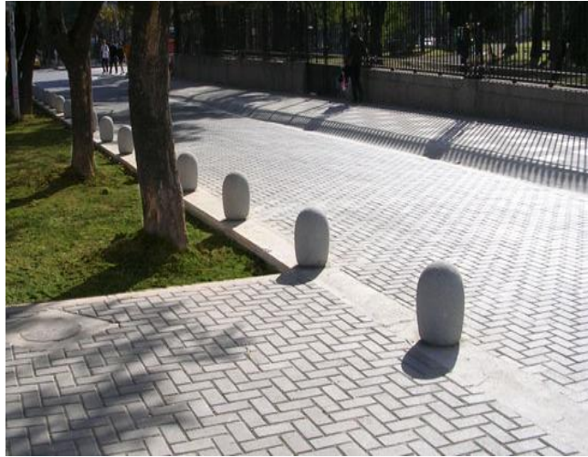
Figura 2.3 Pavimento de adoquines.
