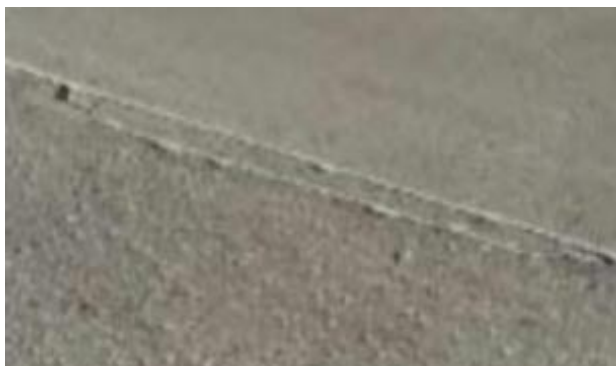
Figura 2.39 Fisuras por mal funcionamiento de juntas
