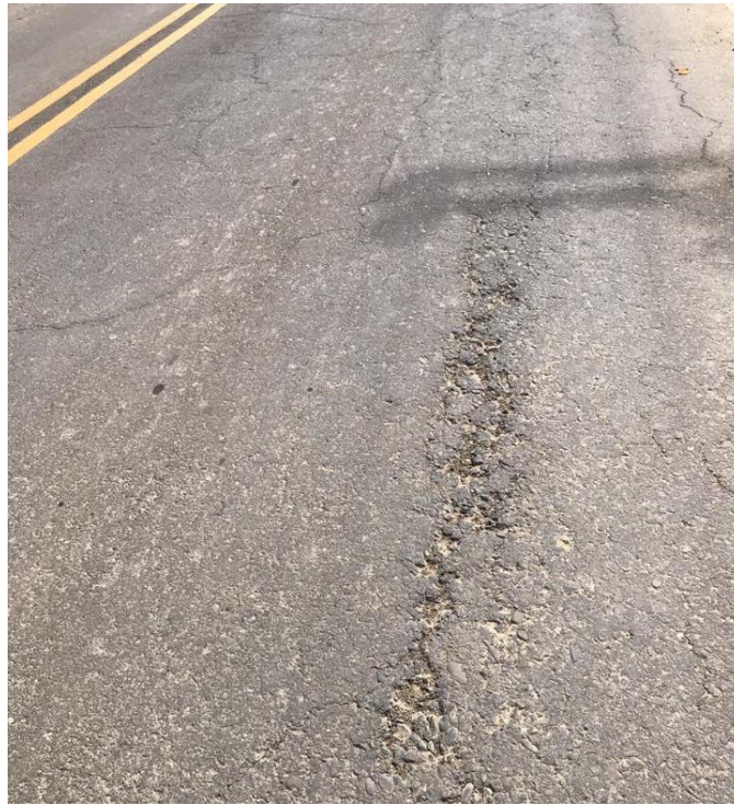
Desprendimiento de agregados
