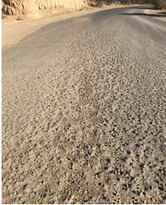
Desprendimiento de agregados
