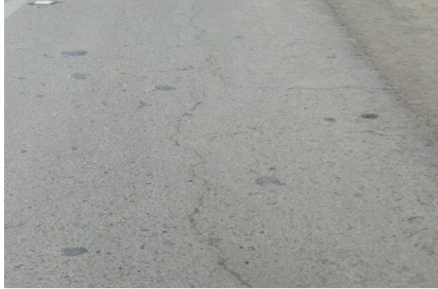
Figura 10. Grietas longitudinales y transversales
