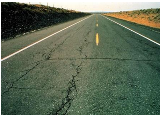
Figura 3. Grietas de contracción de bloque
