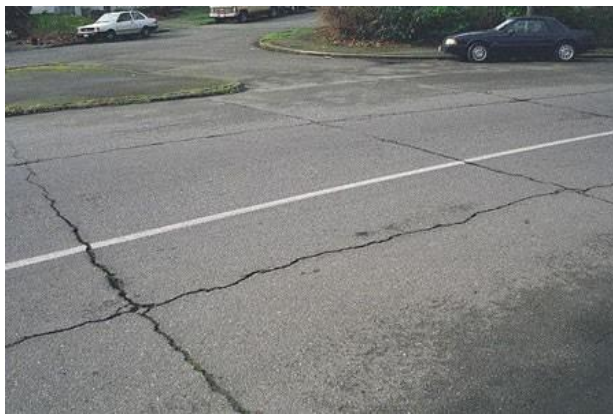
Figura 8. Grietas de reflexión de juntas
