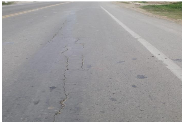
Figura 7. Grietas de borde
