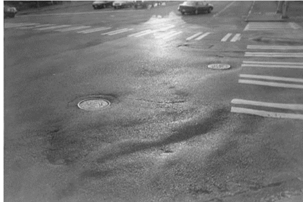
Figura 16. Deformaciones por empuje
