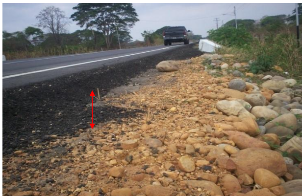
Figura 9. Desnivel entre calzada y hombrillo
