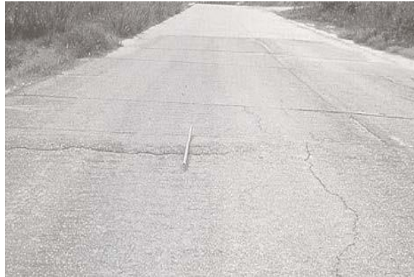
Figura 17. Grietas de desplazamiento
