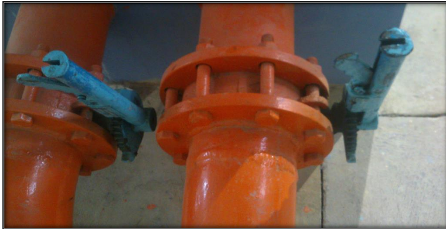
Imagen 2-3 Válvulas de paso
