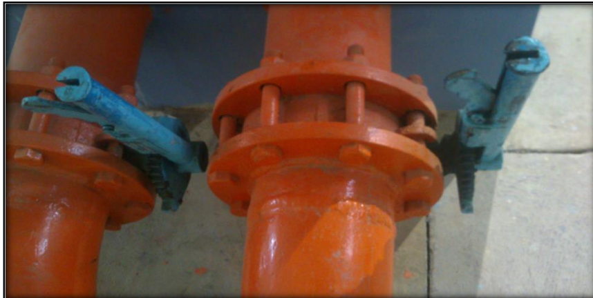
Fotografía 1-4 Válvulas de paso al ingreso al canal Rehbock
