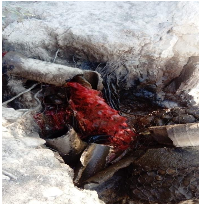
Figura 23. Tubería de salida de las aguas residuales del matadero.
