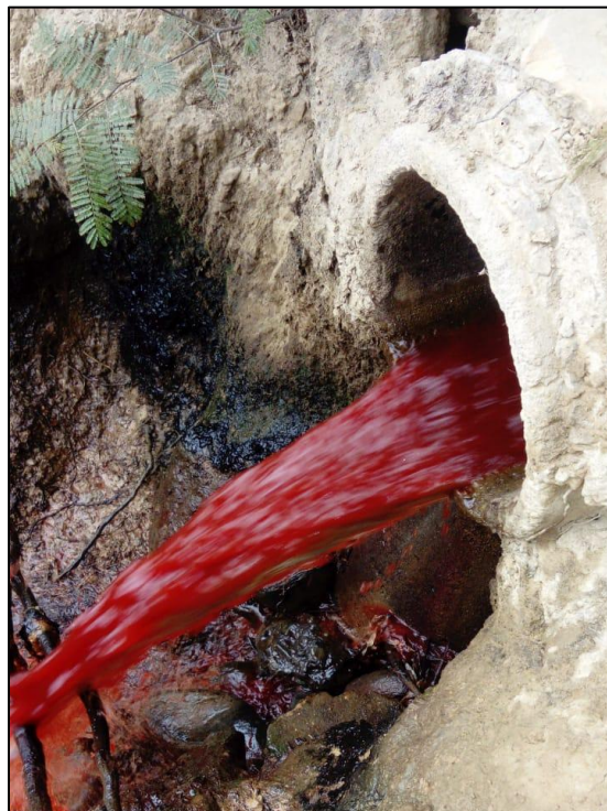
Figura 26. Tubo de salida del efluente residual industrial.
