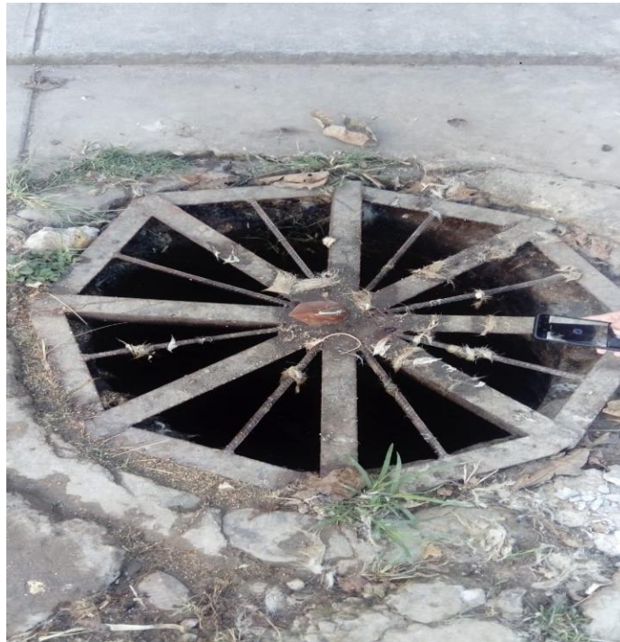
Figura 22. Canal de recolección de aguas residuales del matadero.
