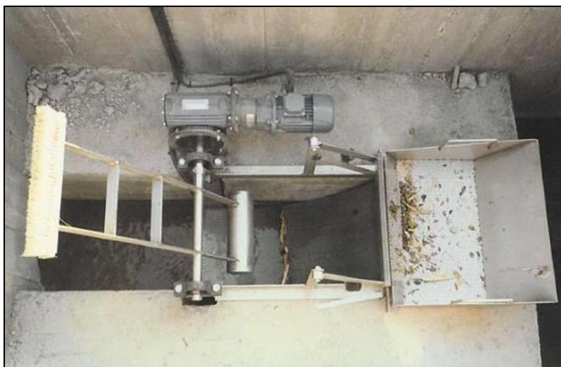
Figura 12. Rejilla de limpieza mecánica con peine giratorio
