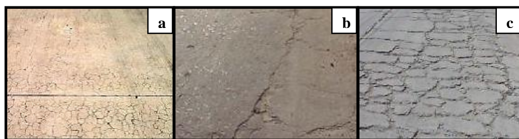
Figura 2.22 - Desconchamiento, mapa de grietas, craquelado
