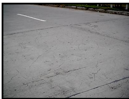
Figura 2.23 - Grietas de retracción
