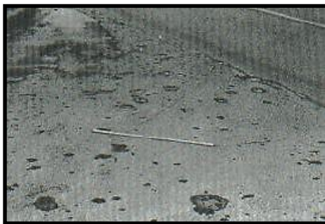
Figura 2.18 - Popouts o desprendimientos superficiales
