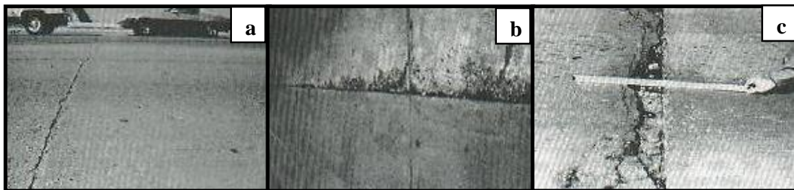
Figura 2.25 - Descascaramiento de junta
