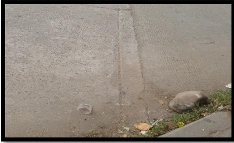
UM-5 (Prog. 0+95,204 a Prog. 0+119,005) Desnivel carril / berma
