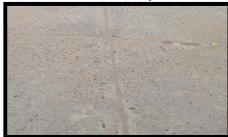
UM-8 (Prog. 0+187,585 a Prog. 0+221,875) Daño del sello de junta
