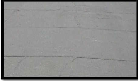
UM-5 (Prog. 0+210,174 a Prog. 0+234,087) Grietas lineales (long., trans. y diag.)
