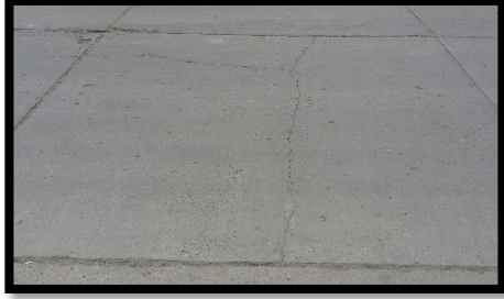
UM-21 (Prog. 0+982,210 a Prog. 1+6,214) Grietas lineales (long., trans. y diag.)
