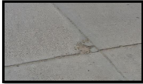
UM-13 (Prog. 0+596,433 a Prog. 0+621,690) Descascaramiento de esquina
