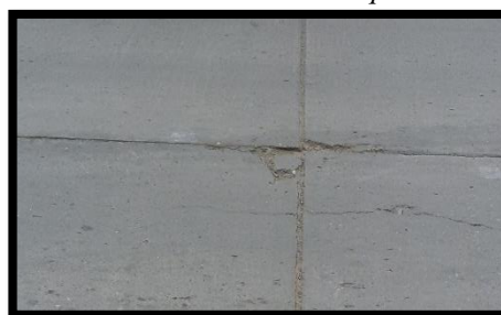
UM-24 (Prog. 1+126,109 a Prog. 1+149,988) Descascaramiento de esquina
