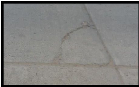
UM-24 (Prog. 1+126,109 a Prog. 1+149,988) Grieta de esquina
