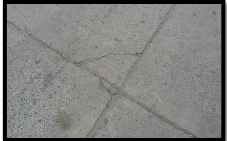
UM-8 (Prog. 0+352,832 a Prog. 0+376,540) Grieta de esquina
