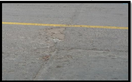
UM-8 (Prog. 0+352,832 a Prog. 0+376,540) Descascaramiento de junta
