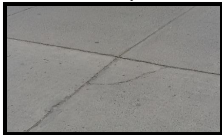
UM-15 (Prog. 0+687,462 a Prog. 0+709,386) Grieta de esquina
