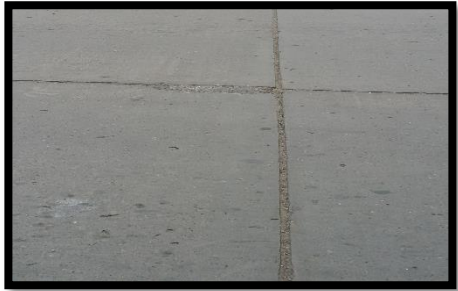
UM-22 (Prog. 1+30,218 a Prog. 1+54,222) Daño del sello de junta
