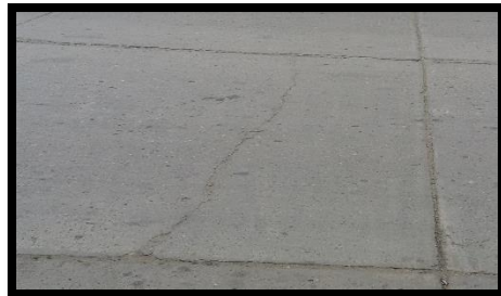
UM-25 (Prog. 1+173,867 a Prog. 1+197,746) Grietas lineales (long., trans. y diag.)
