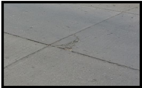
UM-26 (Prog. 1+221,625 a Prog. 1+245,917) Grieta de esquina
