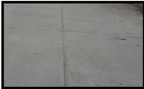
UM-28 (Prog. 1+318,793 a Prog. 1+343,085) Daño del sello de junta
