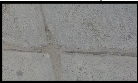
UM-7 (Prog. 0+153,295 a Prog. 0+187,585) Descascaramiento de esquina
