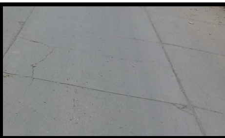
UM-9 (Prog. 0+221,875 a Prog. 0+256,165) Grietas lineales (long., trans. y diag.)
