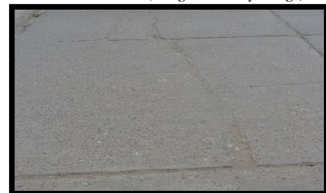
UM-15 (Prog. 0+687,462 a Prog. 0+709,386) Grietas lineales (long., trans. y diag.)
