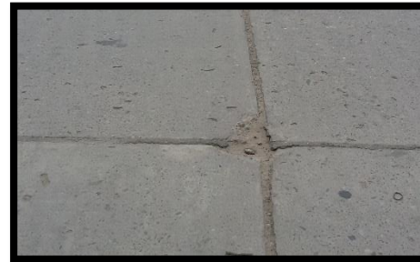
UM-26 (Prog. 1+221,625 a Prog. 1+245,917) Descascaramiento de esquina
