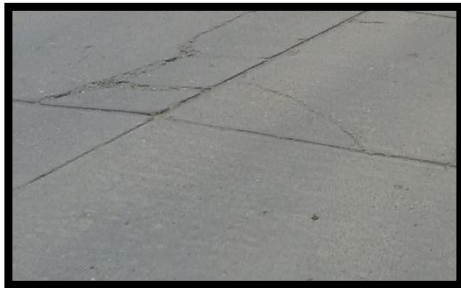
UM-6 (Prog. 0+119,005 a Prog. 0+153,295) Grieta de esquina
