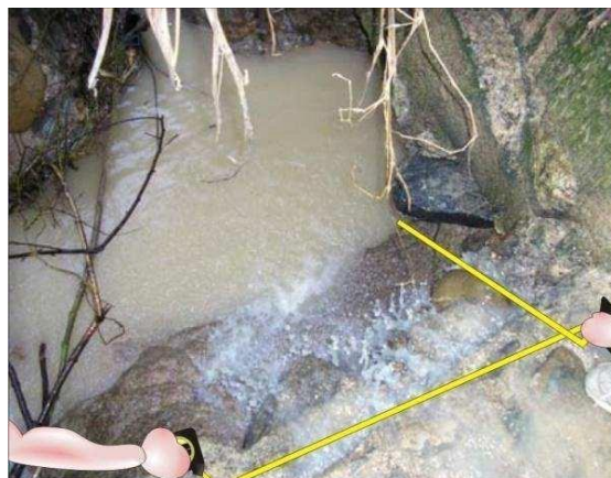
Figura 2.22 Grietas o fracturamiento en canales disipadores
