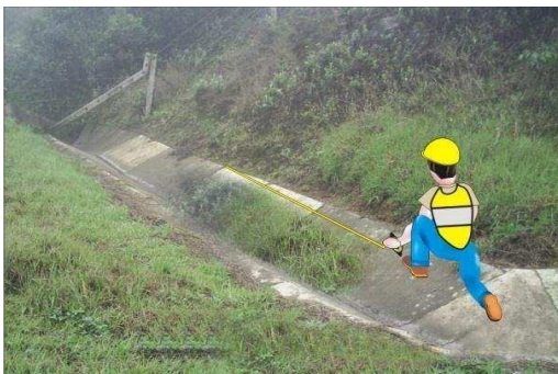
Figura 2.17 Obstrucción de disipadores, zanjas y canales
