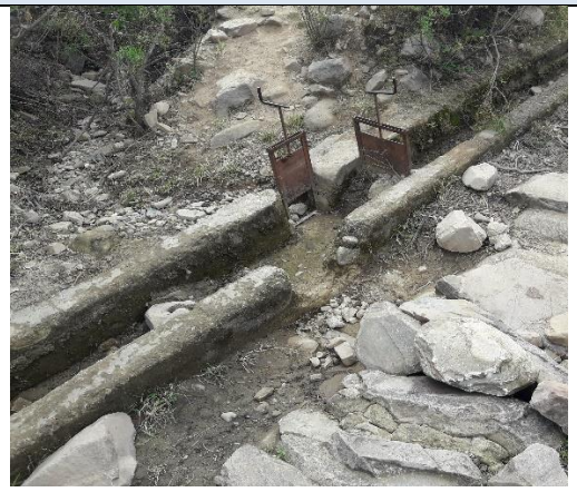
Fotografía No 6: Perdidas Aparentes SISTEMA DE ADUCCION
