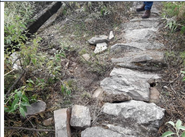
Fotografía No 5: Desgaste del sistema de aduccion SISTEMA DE ADUCCION
