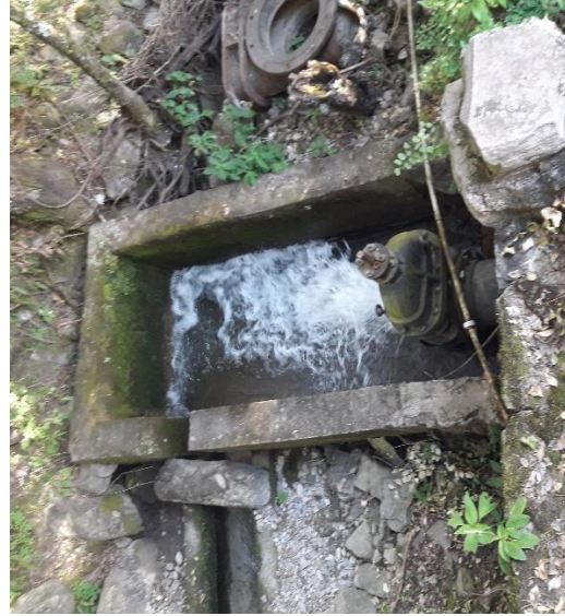
Fotografía No 2: cámara de desfogue sin mantenimiento SISTEMA DE ADUCCION
