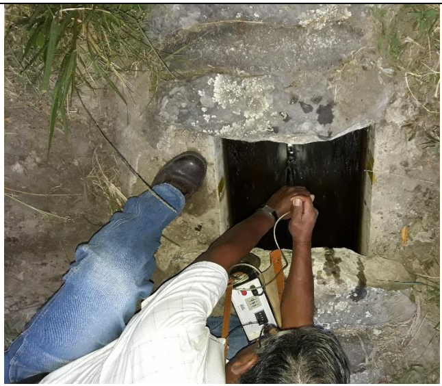
Fotografía No 8: Calibración de Vertedero Rincón de la Victoria CALIBRACION DE VERTEDEROS
