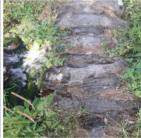
Fotografía No 1: Perdidas Reales SISTEMA DE ADUCCION
