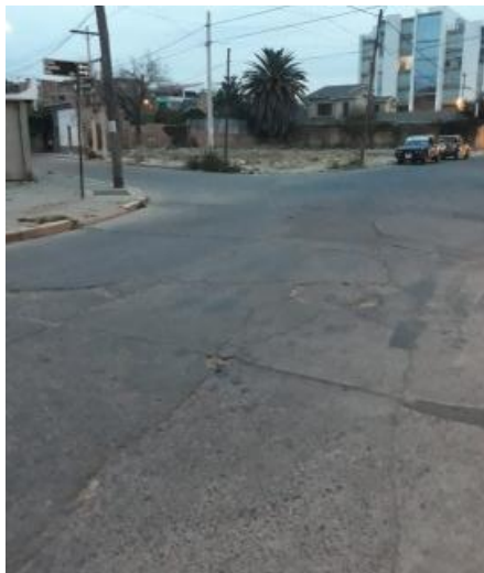
Figura 2.41 Grietas en intersección de calles
