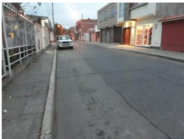
Figura 2.38 Fisuras en calles
