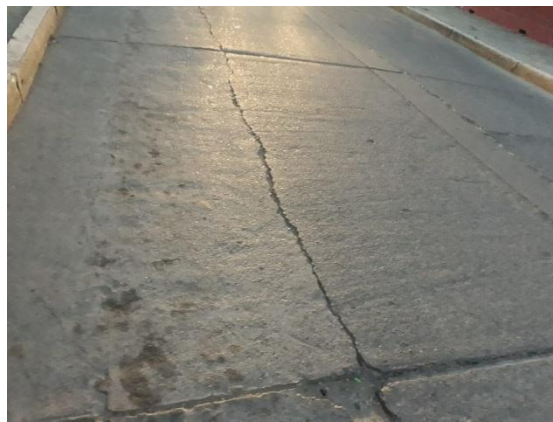
Figura 2.42 Grietas longitudinales en calles
