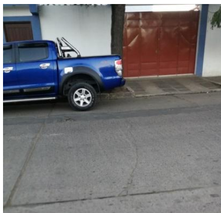
Figura 2.39 Fisura transversal en la calle Padilla
