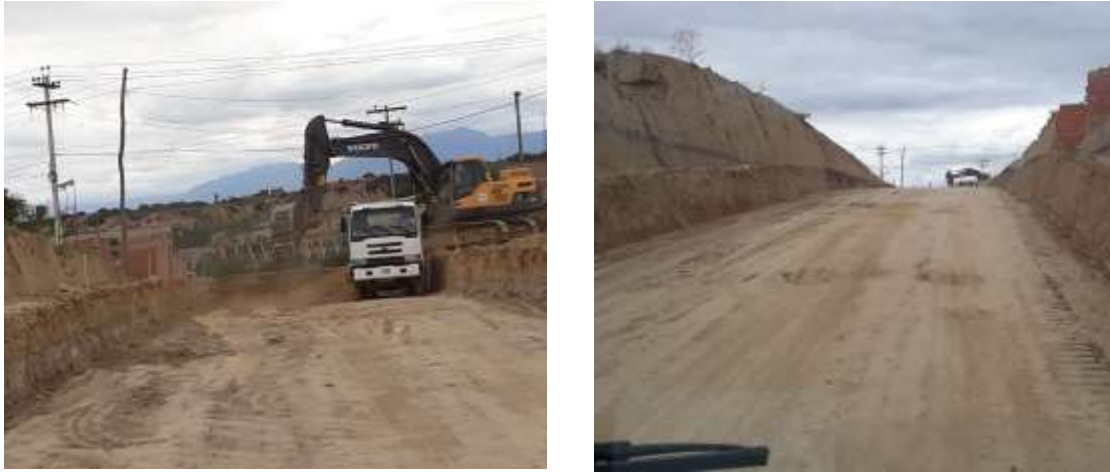
Figura 4.17. Talud barrio San Blas (punto 2)
