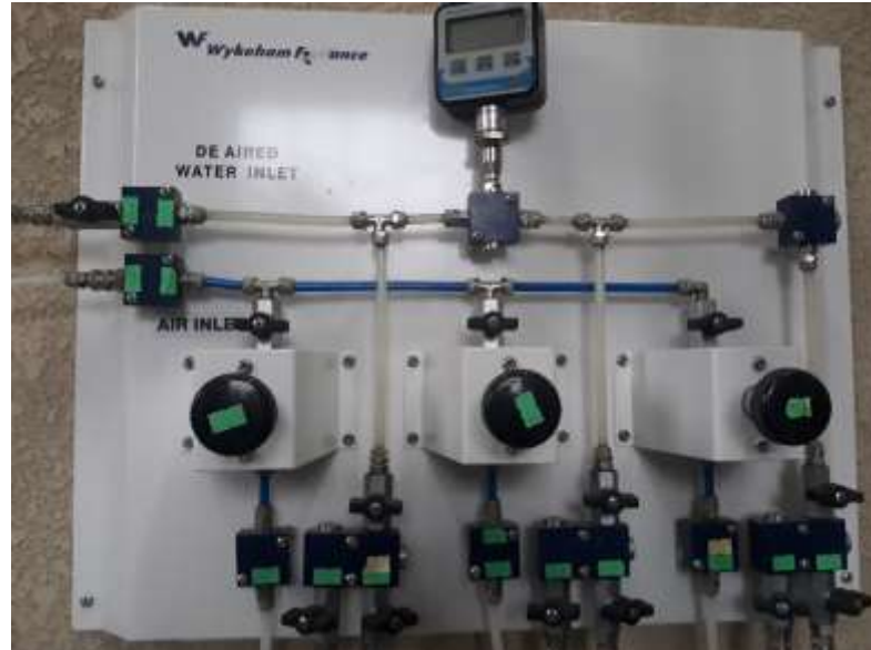
Figura 2.23. Panel de control de agua y manómetro digital
