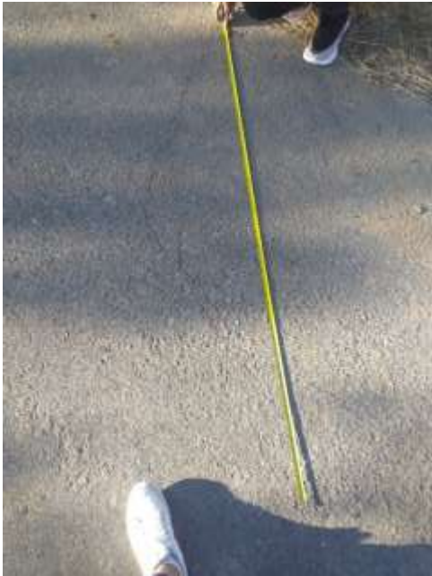
Medición de falla grietas de borde
