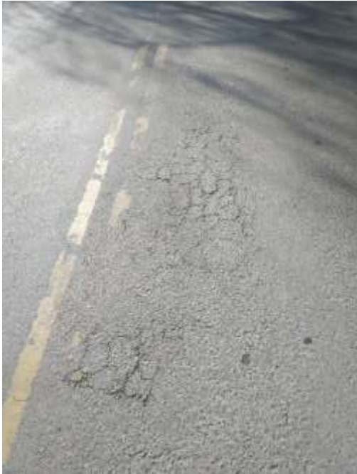
Falla piel de cocodrilo
