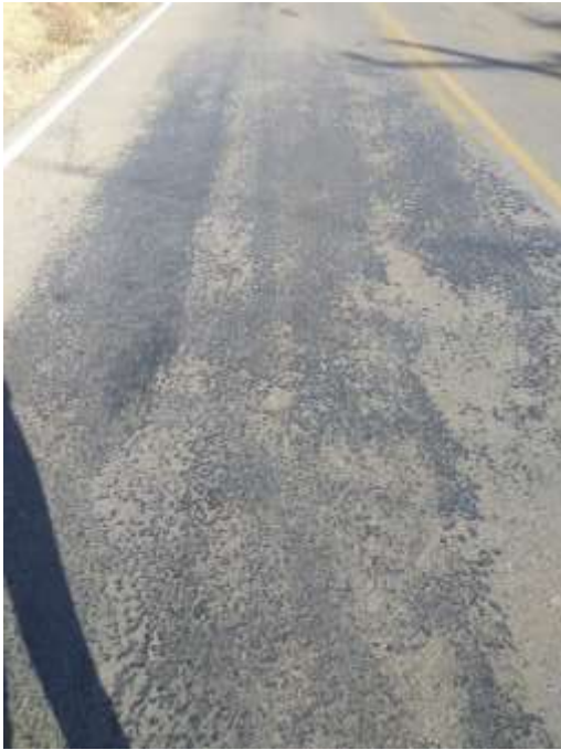
Exudación de severidad baja
