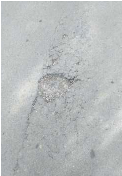
Medición de baches
