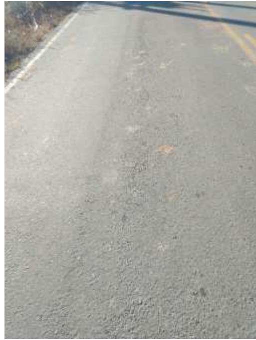
Exudación de severidad media
