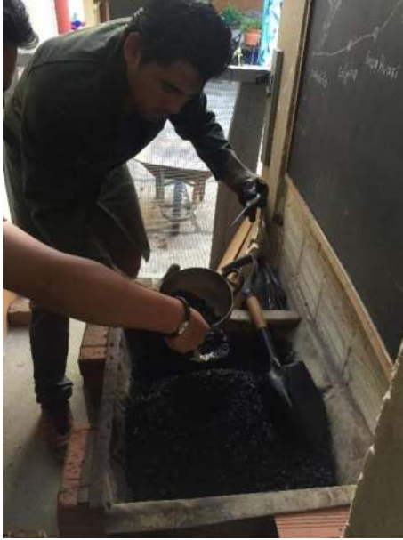
Obtención de mezcla asfáltica para realizar control de la mezcla en obra.
