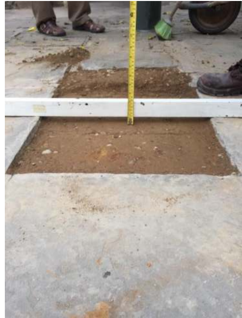
Control de Nivel en área de Trabajo para el sector de Tratamiento Superficial Triple.
