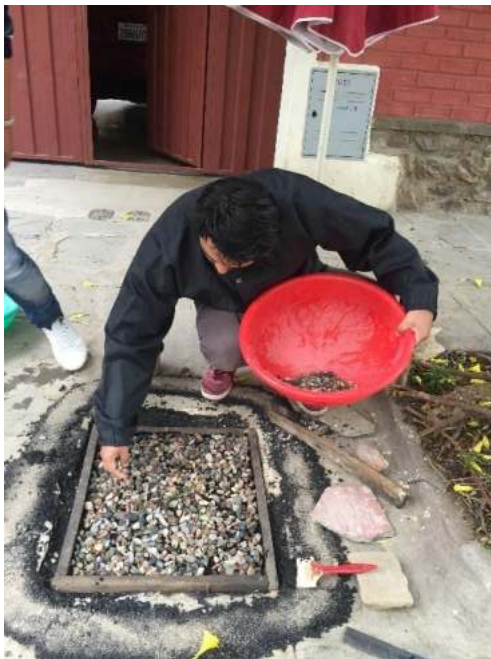
Colocado de la primera capa de agregado pétreo en área de trabajo.
