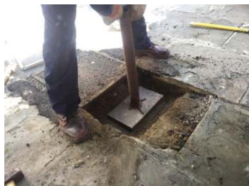
Compactación de Capa Sub Base en área de trabajo con compactador mecánico.
