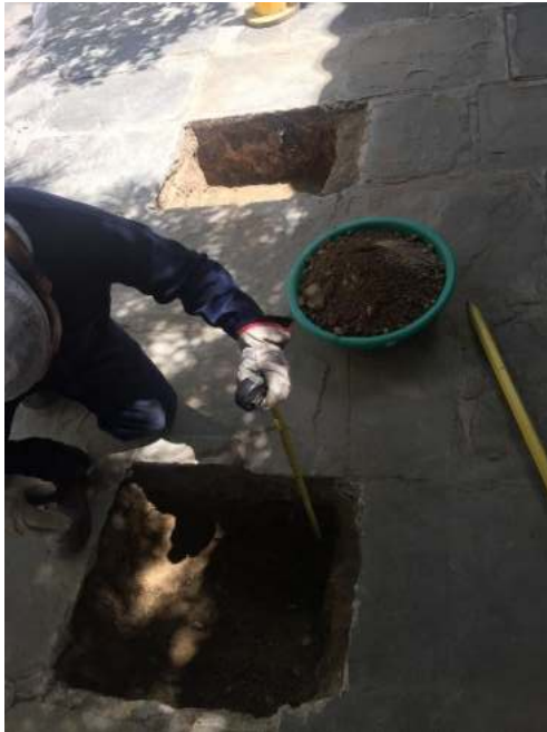
Área de trabajo, extendido de Capa Sub Base, profundidad de hoyo 40 cm.
