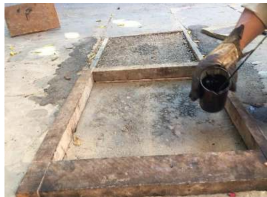
Colocando un riego de liga sobre el área de trabajo para la mezcla asfáltica en caliente.
