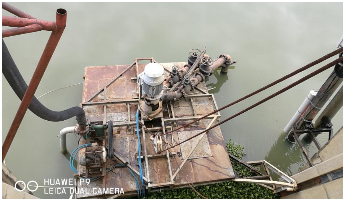
Anexo II. 1. Plataforma Flotante al pie de la estructura de la obra de toma.
