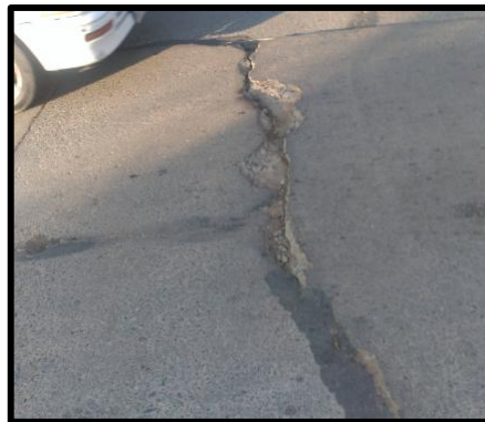
Figura 4. 5. Detalle de fallas
