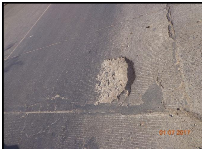
Figura 2. 18. Falla de despostillamiento
