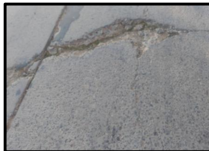
Figura 4. 6. Detalle de fallas
