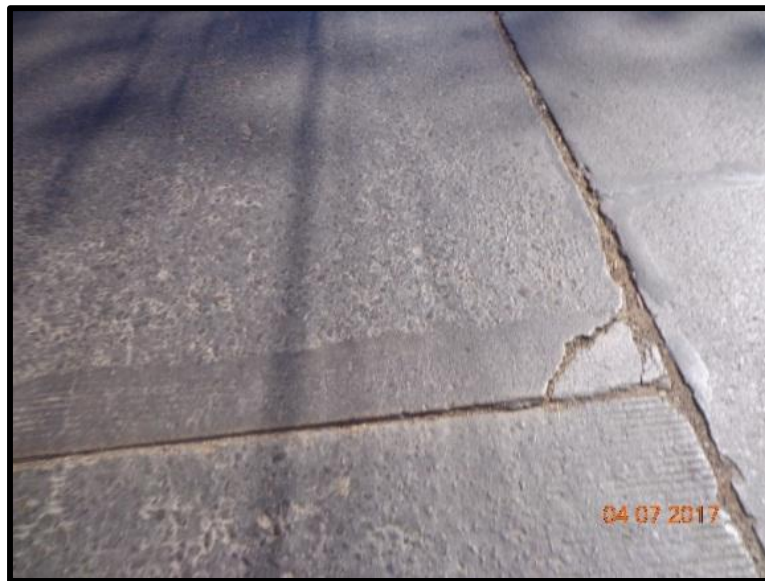
Figura 2. 15. Grieta de esquina
