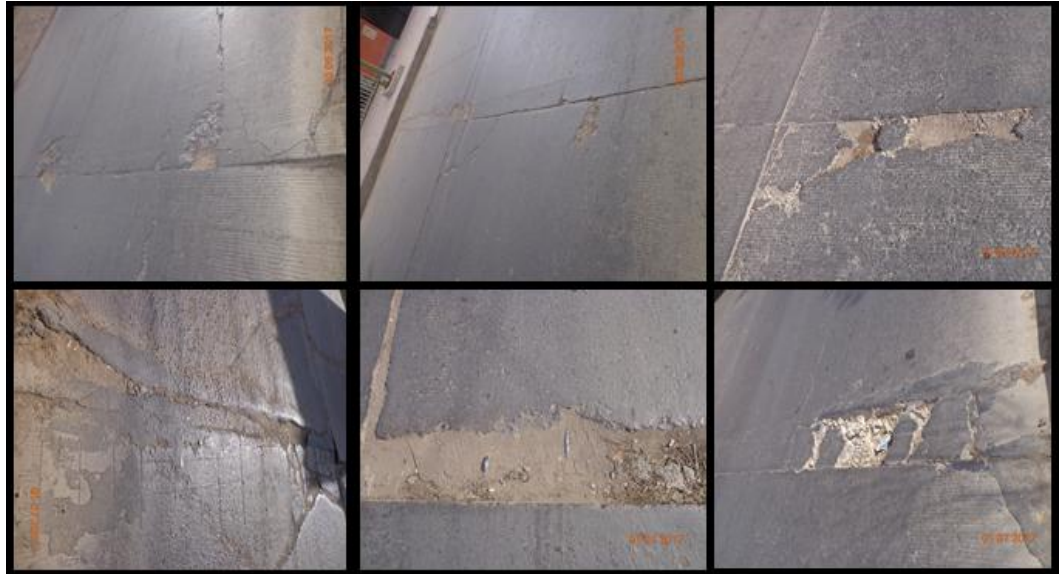
Figura 5. 5. Diferentes tipos de fallas que se presentan en juntas de dilatación del tramo estudiado
