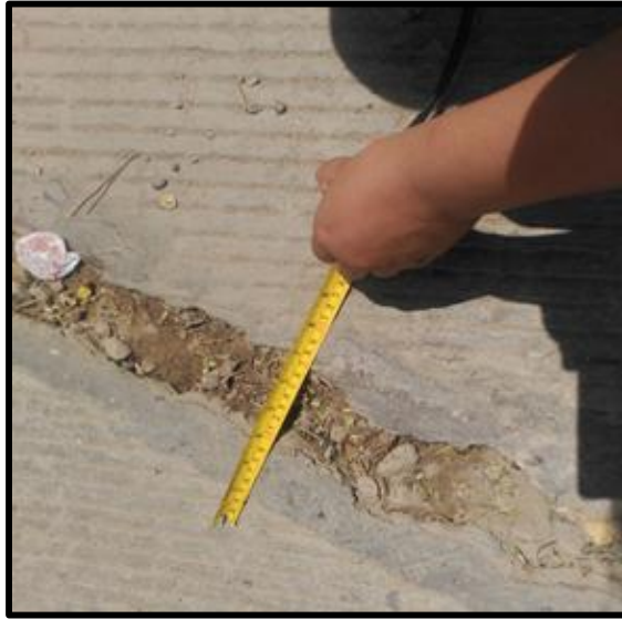
Figura 3. 19. Ejemplo de medición de una falla encontrada en losa
