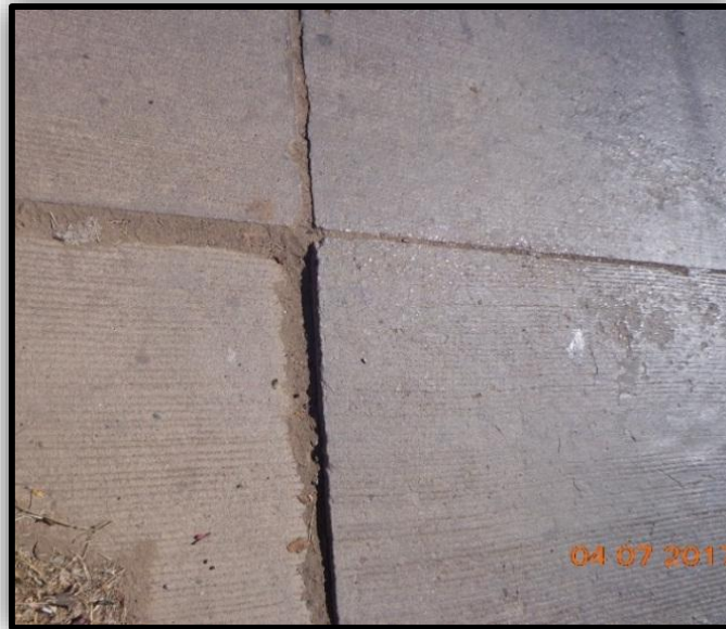
Figura 2. 17. Falla de dislocamiento
