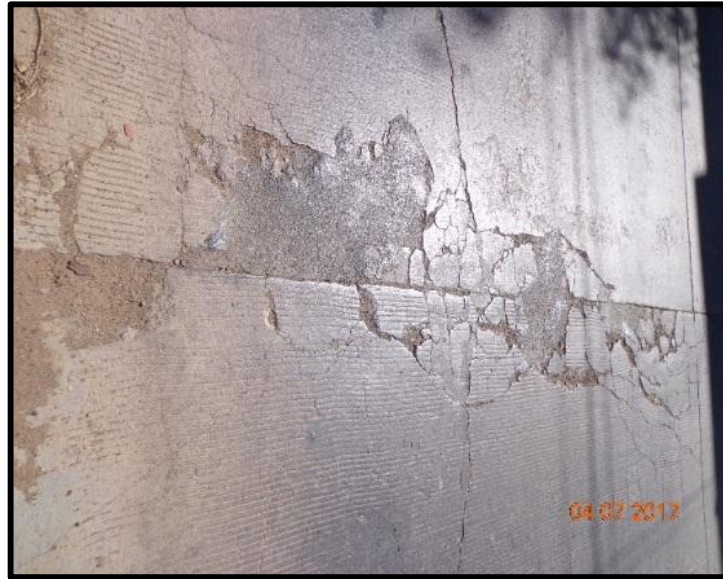
Figura 2. 16. Grietas en extremos de pasadores
