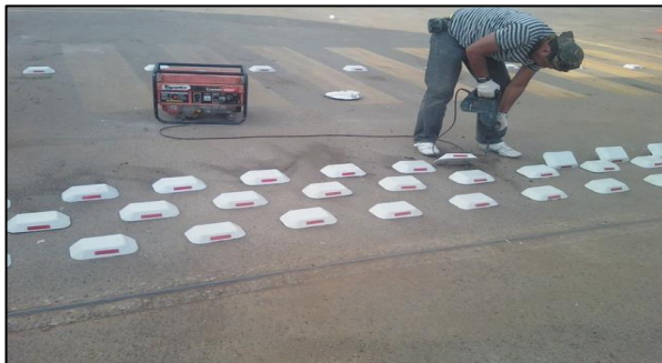
Figura 3.22. Reductores de velocidad con tachones
