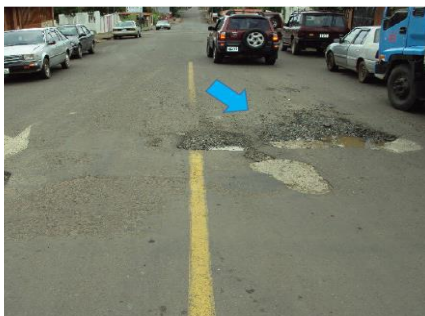
Figura 2.10: Bacheo producto del desprendimiento o stripping
