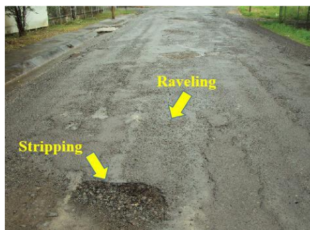
Figura 2.9: Raveling y stripping en pavimentos asfálticos
