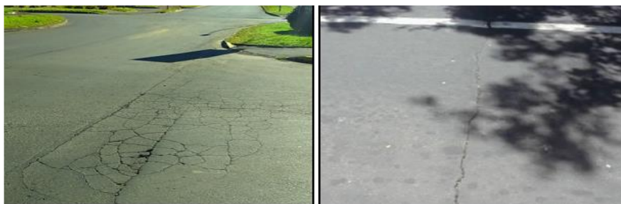
Figura 2.11: Fisuración en bloque y transversal
