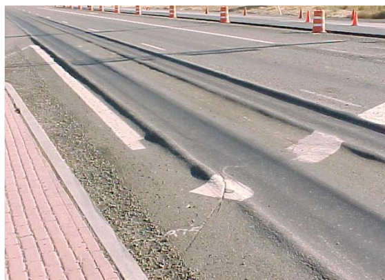
Imagen 2.2: Falla por tensiones superficiales
