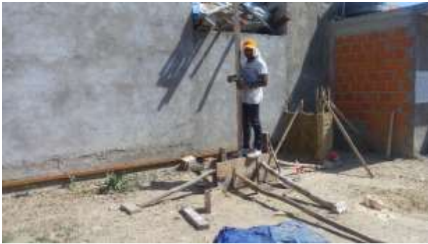
Encofrado mal armado, para la aplicación del muro tapial.
