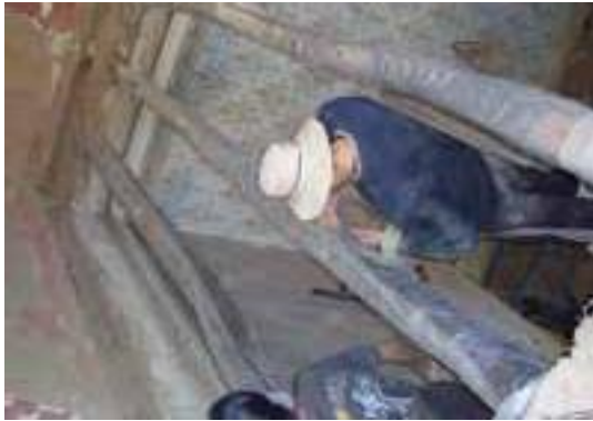
TRATAMIENTO DE UN PRODUCTO ANTI XILOFAGOS, MEDIANTE LA TECNICA DE IMPRIMACION Y PENETRACION PROFUNDA
